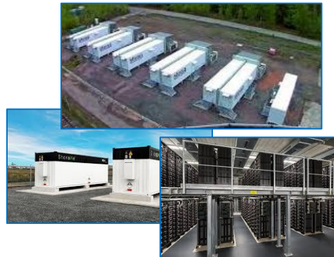
Batteriespeicher ca. 450 MW
